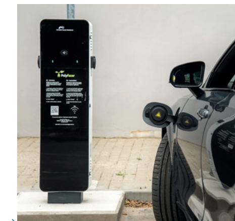
V sousedství centrálního parkoviště vyrostla dobíjecí stanice pro elektromobily.
